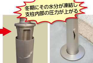
支柱の上部や下部が破損してしまいます。
